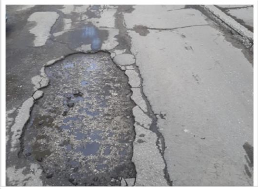
Фото объекта «До»
